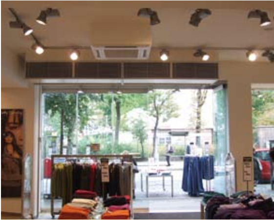
Die alten Torluftschiele (Heizölverbrauch: 20.000 l/a) wurden ersetzt – jeder der hier sichtbaren, neuen Torluftschiele von Mitsubishi Heavy Industries wird jeweils durch eine Außeneinheit des VRF-Systems versorgt.
